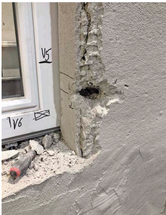
Bild 8 Schäden aus manueller Prüfung Damage from manual testing
