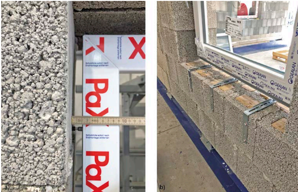
Bild 2 Montagesituation in der Wand (Ansicht innen): a) Befestigung in der Laibung; b) Befestigung im unteren Anschlussbereich Mounting situation in the wall (view from inside): a) fixing in the reveal; b) fixing in the lower connection
