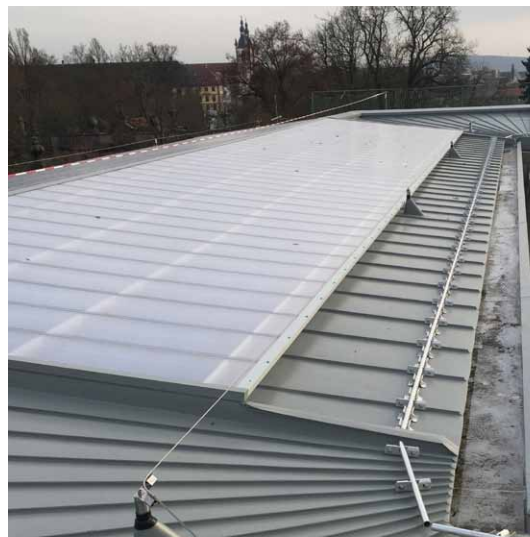
Dachkollektor unter einer Polycarbonat-Deckung zur solaren Energiege- winnung (BGV Fulda)
